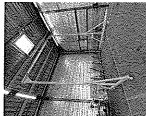
Zone pont roulant avec ligne de air et climatisées
