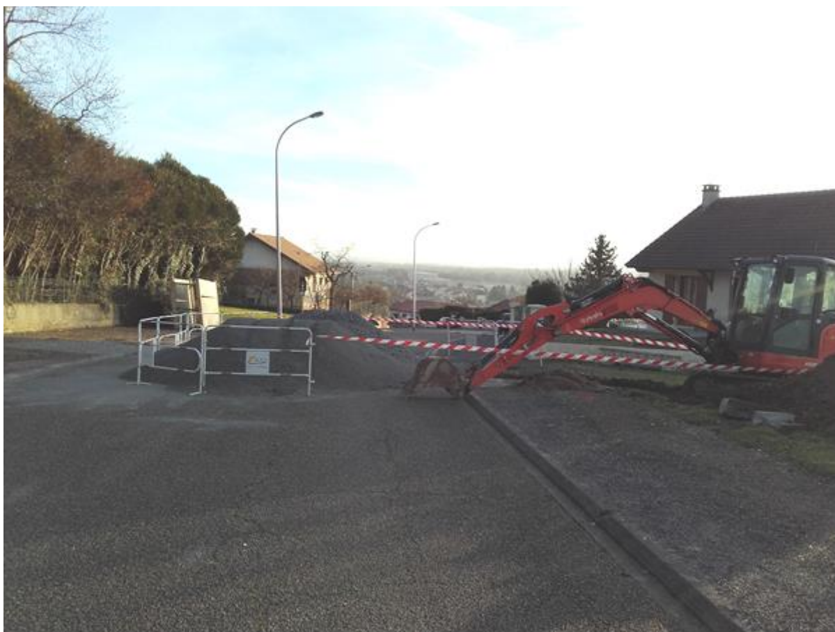
Raccordement au réseau
